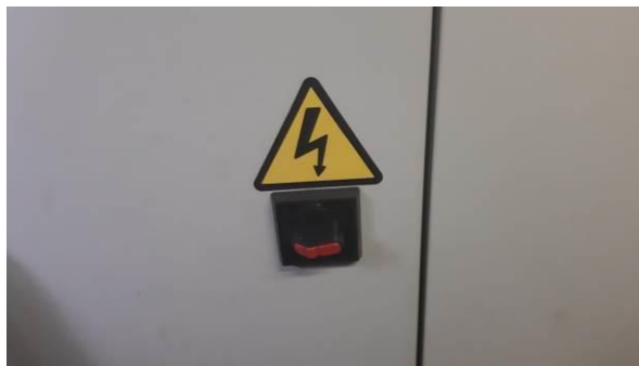
Seccionador Q321 en posición abierto. De esta forma, se corta la alimentación de los motores de giro de la góndola.
