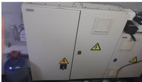
Armario eléctrico A3. Ubicado en la góndola en la parte delantera derecha.
